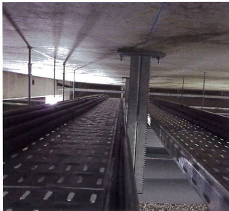
Photo de chemin de câble et de supportage de tuyauterie fournie par Cita production.
